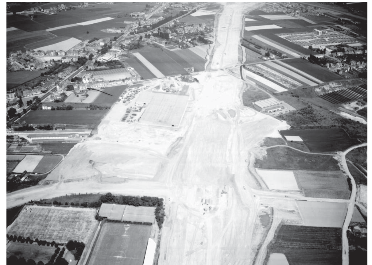
L'E40 au moment de sa construction dans les années 1970 (à gauche, le parc des sports de la commune de Saint-Josse)
