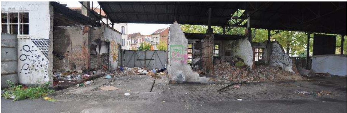
Foto 27: Bouwvallige structuren in de steenkoolhal (Foto : ABO)
