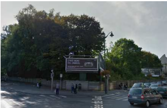
Foto 46: Steunmuur in het noordoosten van de site, op de hoek van de Gentseseenweg en de Vandepereboomstraat (bron: Google maps)
