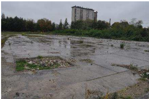
Foto 9: Betonnen zone met plasvorming van regenwater, in het noorden van de site (Foto: ABO)
