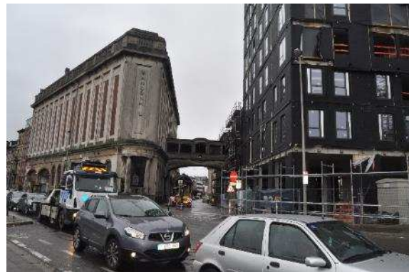
Foto 65: Verbinding tussen de brouwerij Vandeneuvel en de EKL-woontoren op de punt van het huizenblok. Stand van zaken op 24 oktober 2017 (Foto: ABO)
