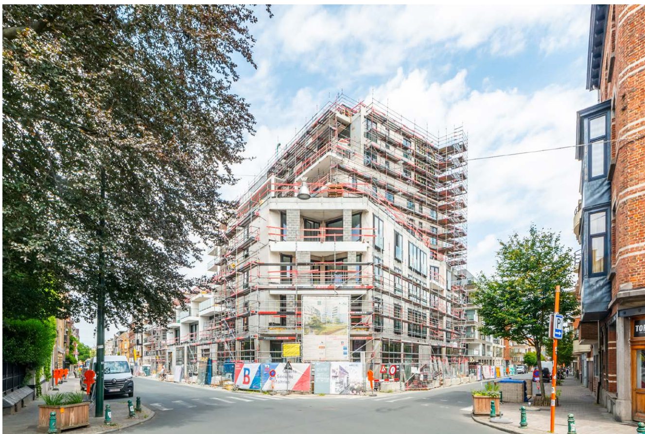
↑ Projet Cavell Court : opération de démolition-reconstruction d'un hôpital vers un ensemble résidentiel, coin des rues Edith Cavell et Marie Depage, Uccle
