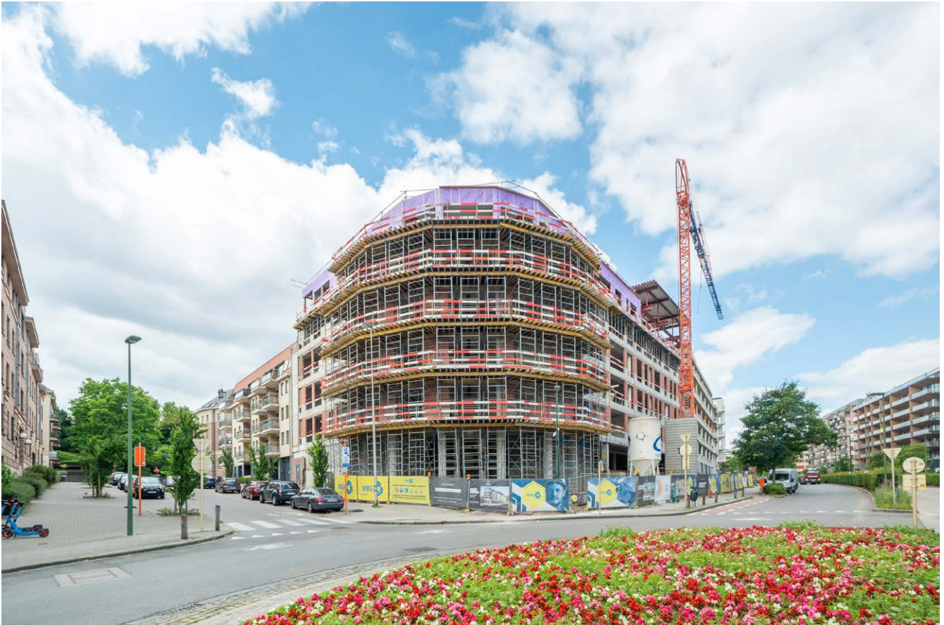
↑ Projet de conversion d'un immeuble de bureaux en logements, avenue Marcel Thiry, Woluwe-Saint-Lambert Project voor de verbouwing van een kantoorgebouw tot woningen, Marcel Thirylaan, Sint-Lambrechts-Woluwe
