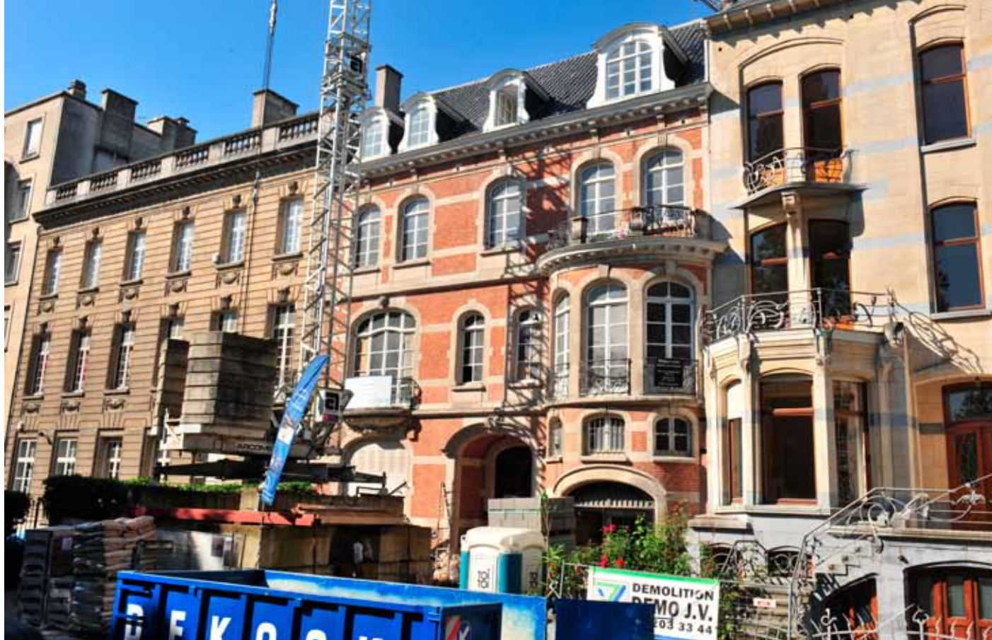
Avenue du Général de Gaulle 40. Retour à la fonction résidentielle d'une maison bourgeoise. Generaal de Gaullelaan 40. Een herenhuis dat terug wordt geconverteerd naar de woonfunctie. Avenue du Général de Gaulle 40. A town house returns to residential use.
