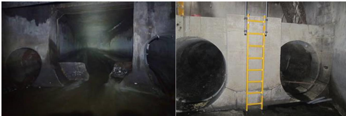
Figure 43 : Arrivée du collecteur du Molenbeek dans la chambre de visite rive gauche
