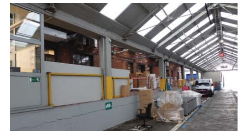
Foto's van de scheuren Photos des fissures
